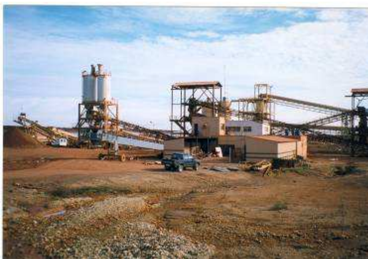
Instalaciones de trituración primaria y secundaria
