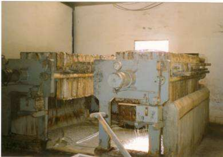
Filtro clarificadores para limpiar la solución
