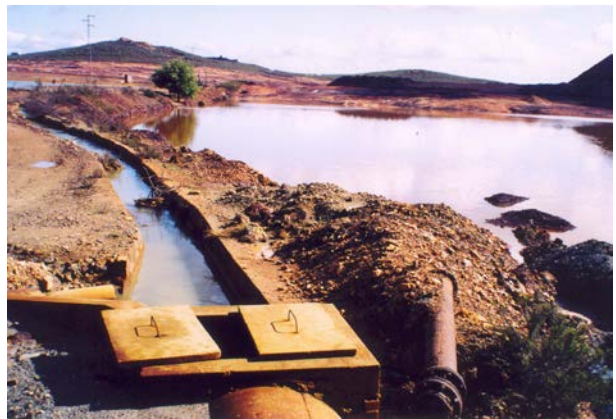
Colector de salida de depuradora Tharsis
