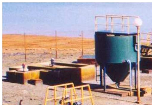
Tanque mezcla y floculación para aditivos
